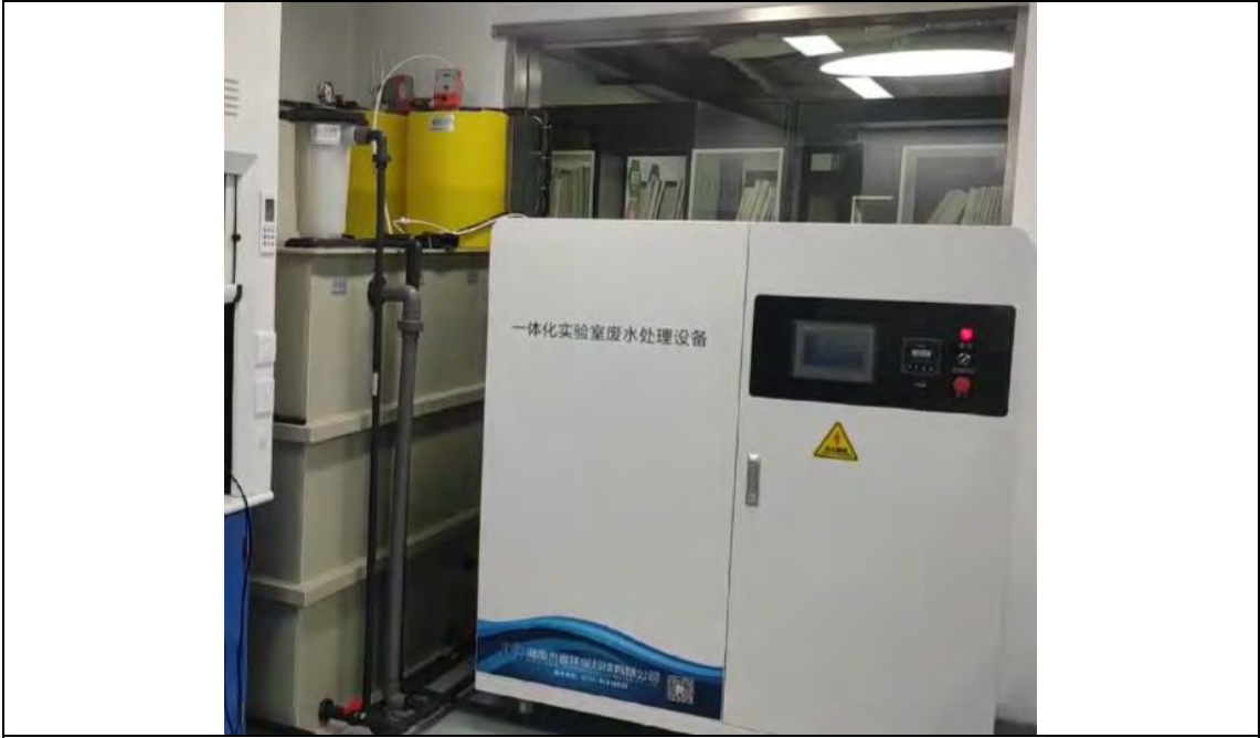
废水处理装置
